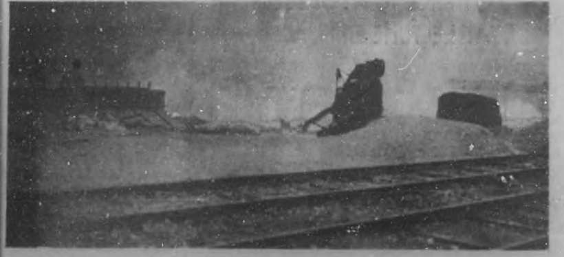
EL TEMPORAL DE AGUA.—Vista de los destrozos causados por el temporal en las obras de prolongación de la Avenida del Golfo.—(Fot. Santa Coloma.)
